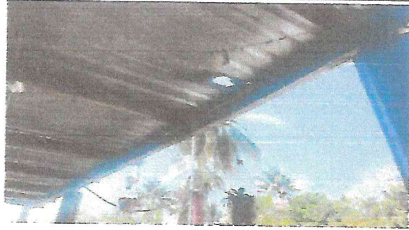
Foto 1: Lamina en mal estado presenta agujeros debido al salitre
